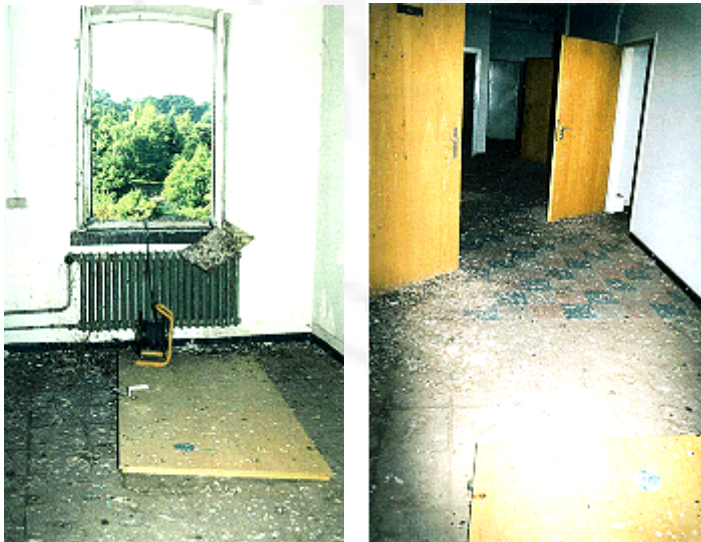
Abb. 3a, b: Taubenkotkontamination, die gut absaugbar ist
